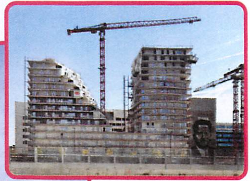
L'aménagement de l'avenue de France se poursuit avec à la clé la construction de nouveaux logements.
